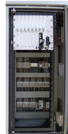
Nou regulador MSF a instal·lar
