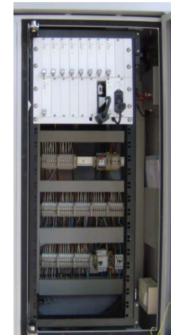
Nou regulador MSF a instal·lar
